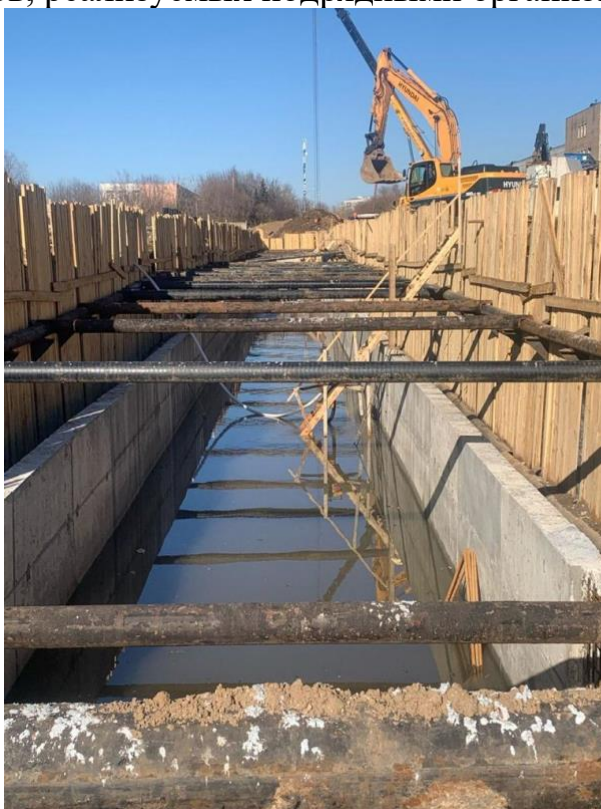
Рис. 2. Затопление траншеи грунтовыми водами при устройстве сетей теплоснабжения
