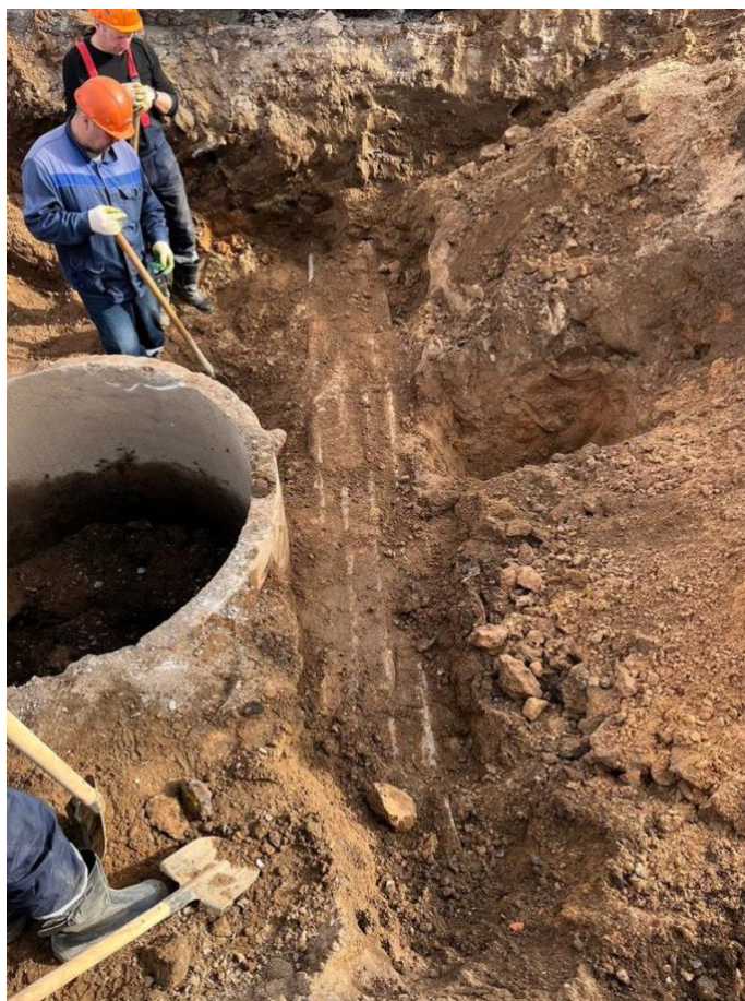
Рис. 3. Обнаружение коммуникаций, не отмеченных на чертежах
