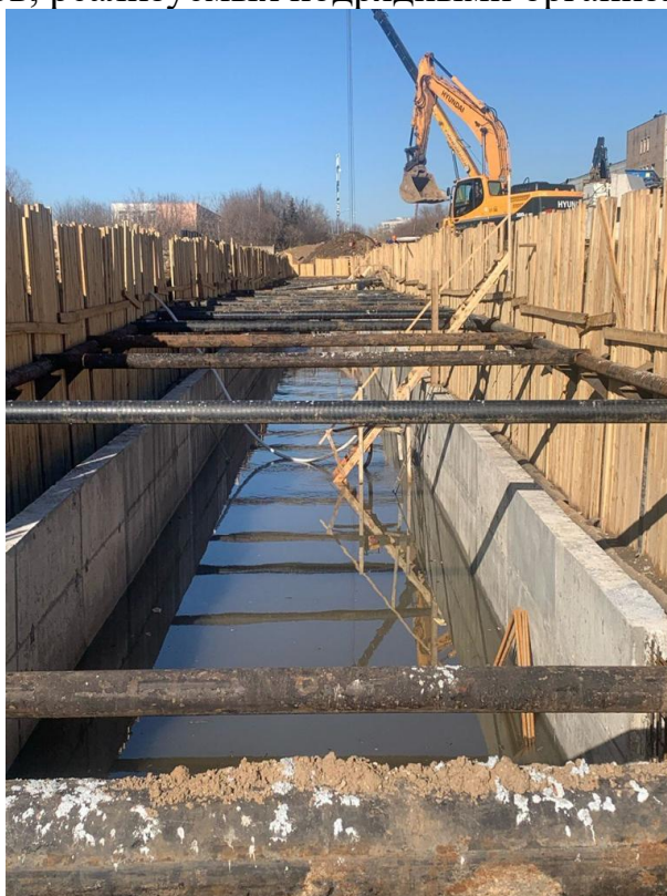
Рис. 2. Затопление траншей грунтовыми водами при устройстве сетей теплоснабжения
