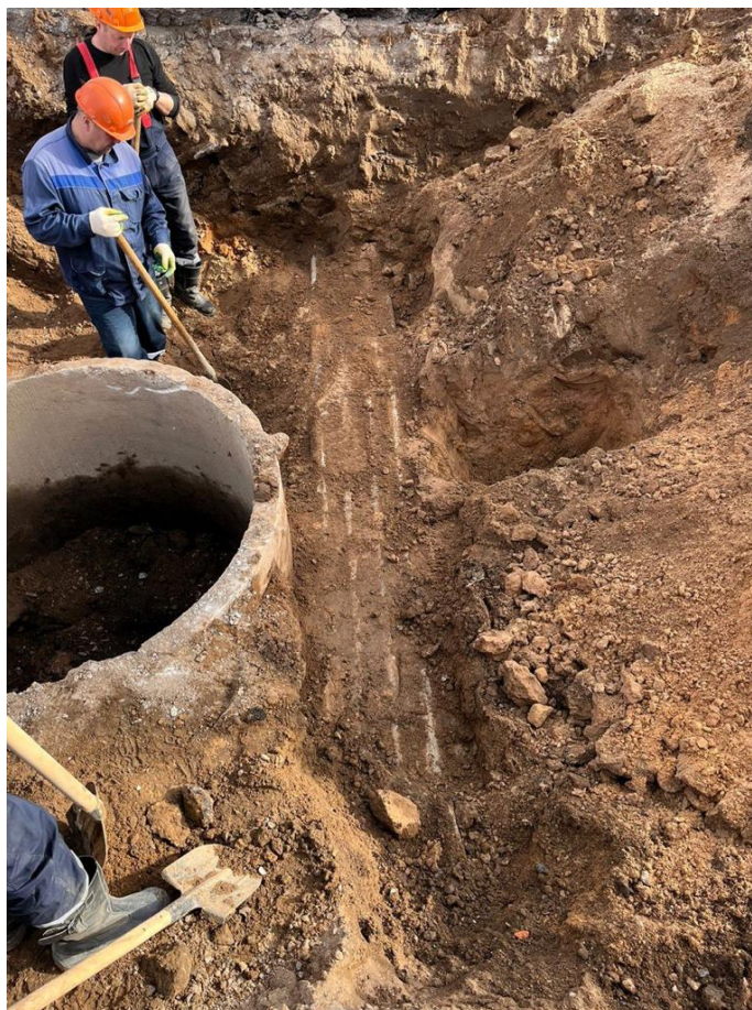
Рис. 3. Обнаружение коммуникаций, не отмеченных на чертежах
